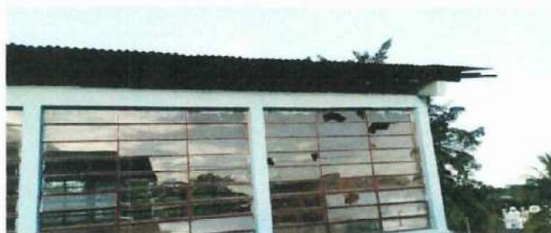
Foto 3: ventanas sin mantenimiento, con daños ocasionados por antigüedad
